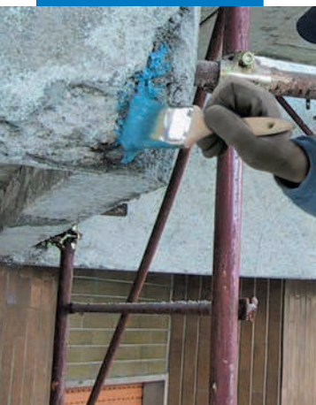
Applicazione a pennello di Mapefer 1K sui ferri di armatura di un balcone in calcestruzzo armato
