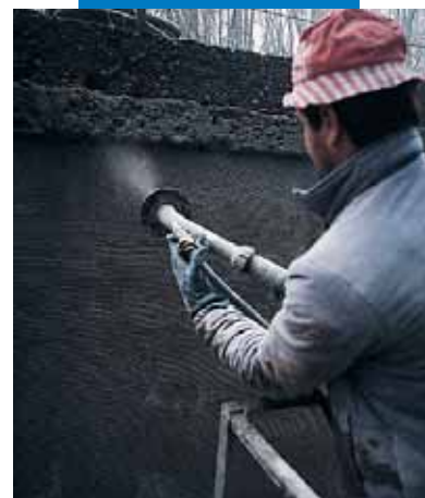
Verarbeitung von Mapegrout Tissotropico im Spritzverfahren im "Hydroelektrikkanal Bertini" - Robbiate (Como) - Italien
