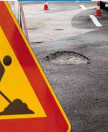
Reparaturstelle im Straßenbelag
